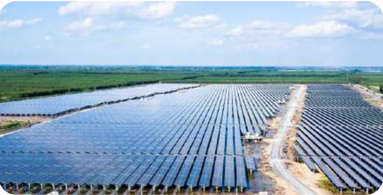
Nhà máy điện mặt trời BCG Bắg Dương
